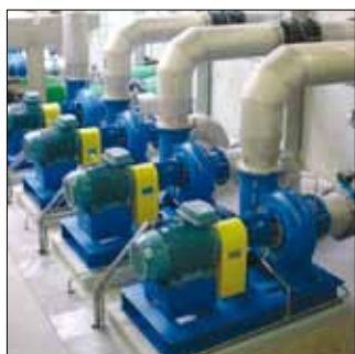
Pompes de reprise à la postfiltration
