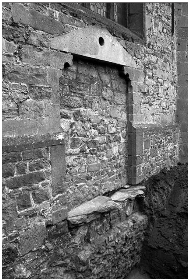
Façade nord du bas-côté nord : fondation, élévation et porte supposée « du Paradis ».
