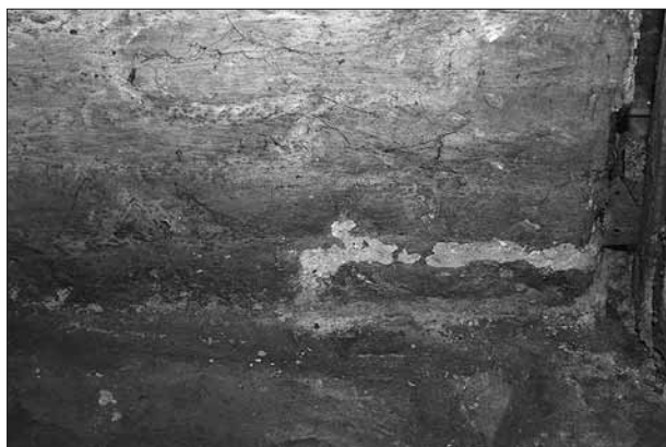
Décohésion du mortier suite à une accumulation de sels au bas des maçonneries dans les caves du n° 10.
